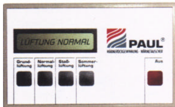
Abbildung 6: Bedienteil des Lüftungsgerätes im Windfang
